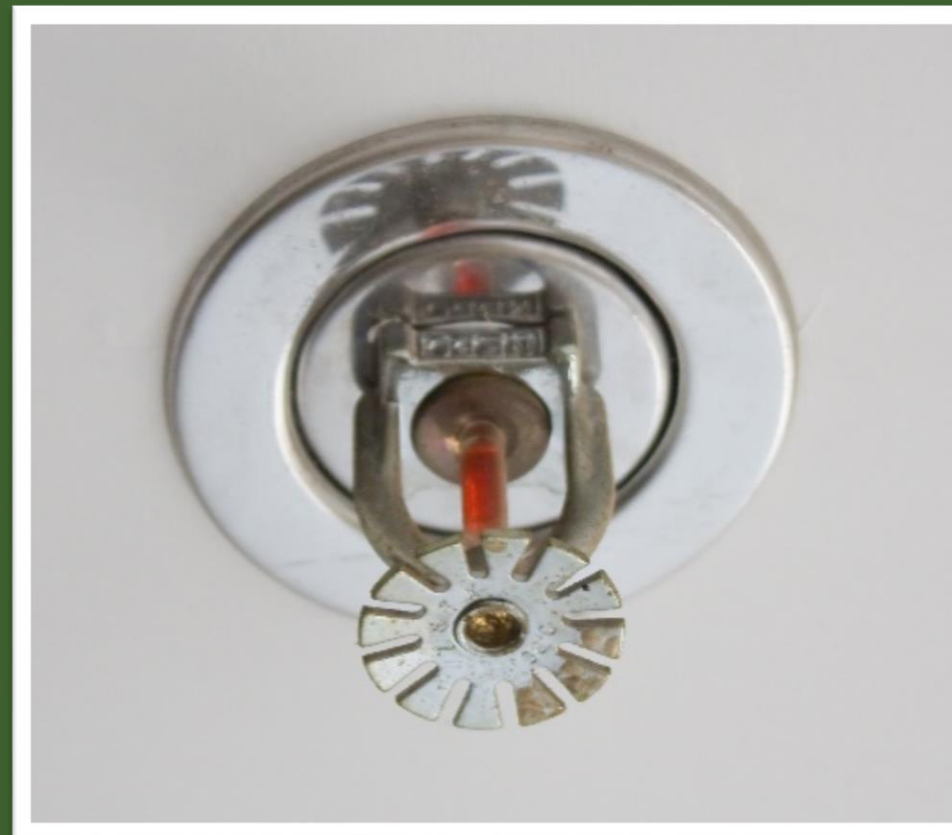
Pemercik air (water sprinkler)
